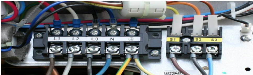
Иллюстрация 8: Подсоединение проводов компрессор-клеммы:
